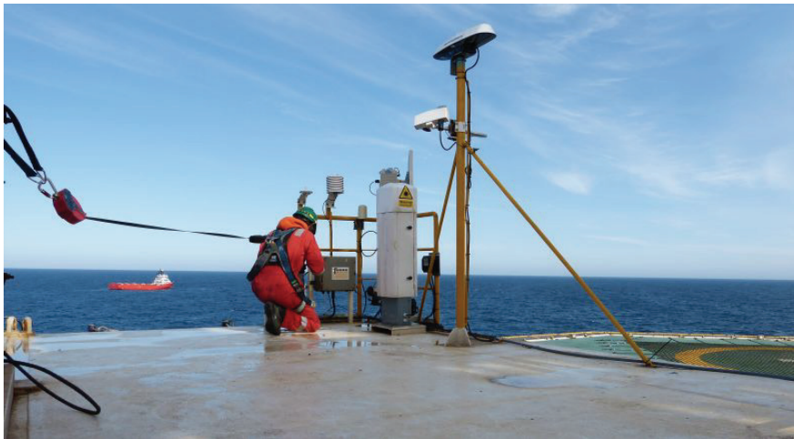
Kuva 8: Vaisala Oyj:n Helideck –mittausjärjestelmän asentaminen käynnissä. Järjestelmä sisältää fotoniikkaan pohjautuvat pilvenkorkeusmittarin sekä näkyvyyden ja vallitsevan sään mittausanturit (Lähde: Vaisala Oyj)
